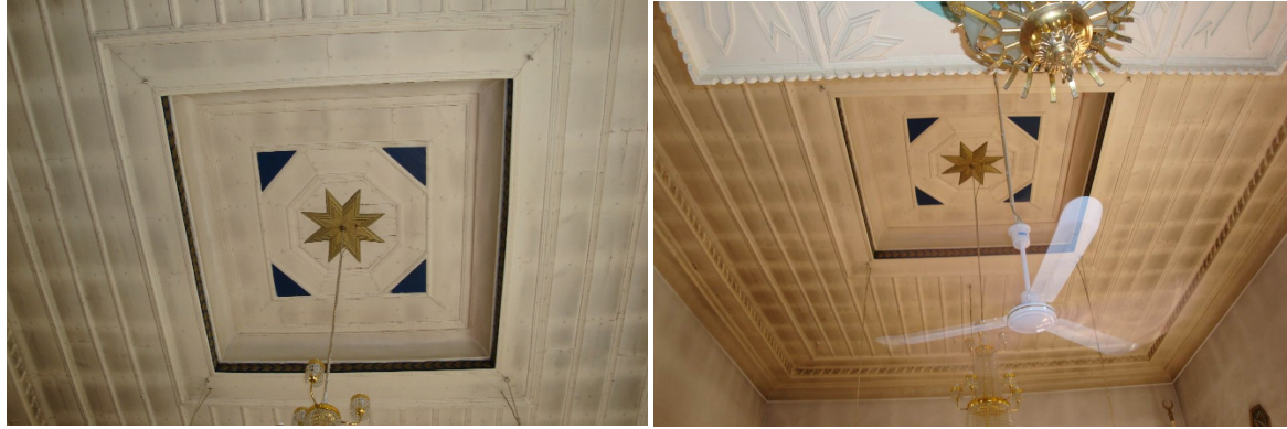
Şekil 4. Onarım öncesi ahşap tavan ve tavan göbeği (Kaynak: Yazara ait fotoğraf arşivi)
